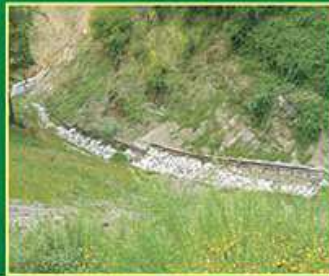
Drenaggio superficiale di versante
