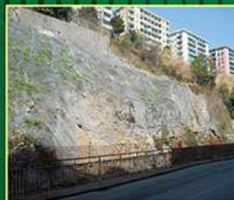
Rete metallica su versante franato
